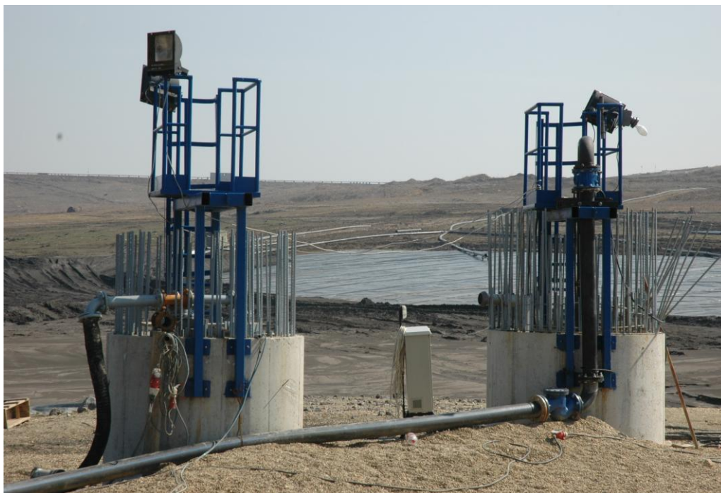
Slika br.3 - Crpne stanice
