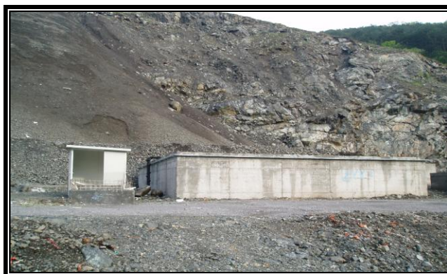
Slika 11 – Laguna izgrađena na dnu sanirane deponije „Vujan“ u Gornjem Milanovcu za sakupljanje netretiranog filtrata (foto: M. Rakijaš, 2008)
